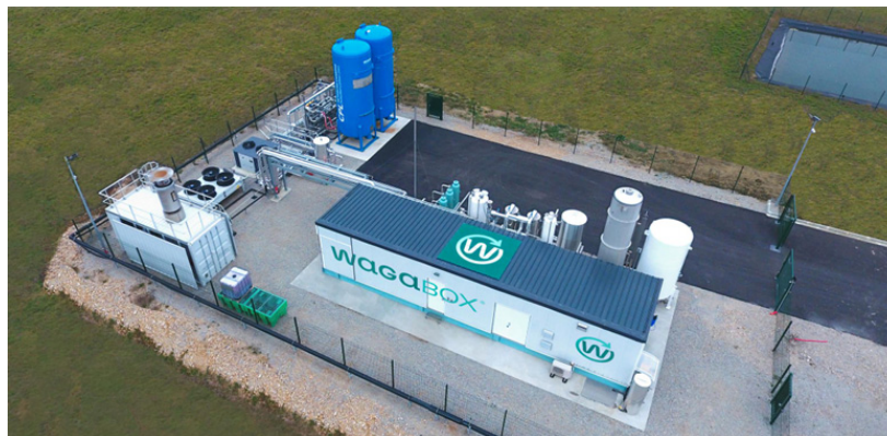
Quelle: Waga Energy, WAGABOX #8, Suez Mülldeponie, Frankreich 2020
