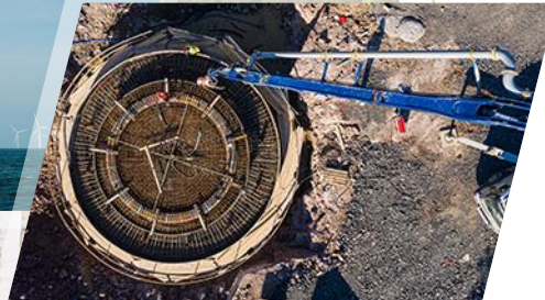
WINDPARK „BÄCKHAMMAR“ SCHWEDEN
