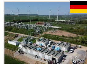
BCP Battery holding Batterie-Speicherkraftwerk
