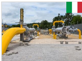
Società Gasdotti Italia Fernleitungsnetzbetreiber
