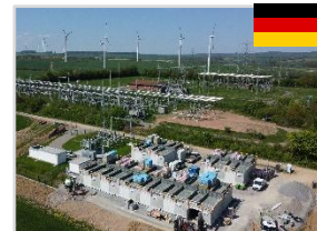
BCP Battery Holding Batterie-Speicherkraftwerk
