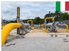
Società Gasdotti Italia Fernleitungsnetzbetreiber
